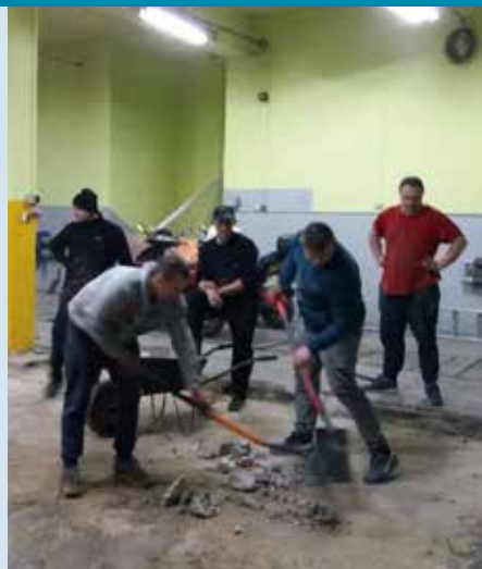
Strażacy nie żałują czasu ani sił przy remoncie posadzki, która zaczęła pękać
